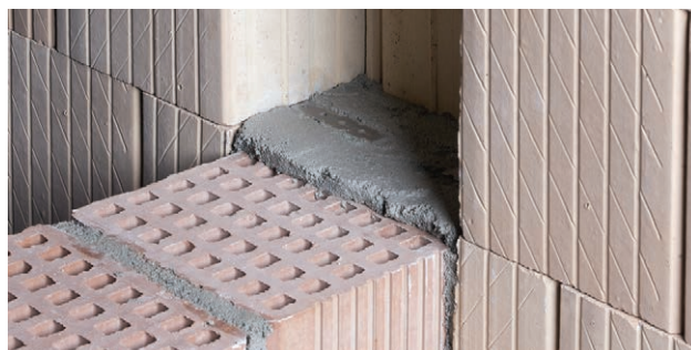
33. Hanggátló fal (25/30 AKU) és LeierPLAN elemekből falazott külső teherhordó fal csatlakozása bekötőszalaggal
